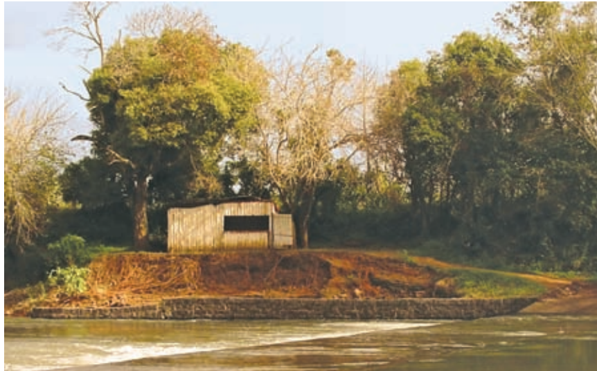
Foto 35: Eingebrochenes Ufer des Rio Soturno, August 2005 (© Fabrício J. Sutili).
