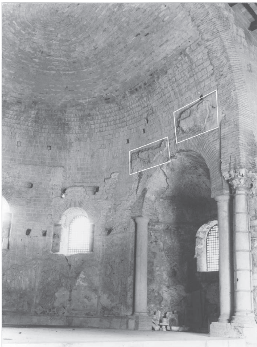
Abb. 5: Cimitile. Basilica Nova, Blick in die Apsis und auf die Ostkonche (darüber die noch erhaltenen Reste des Apsismosaiks)
