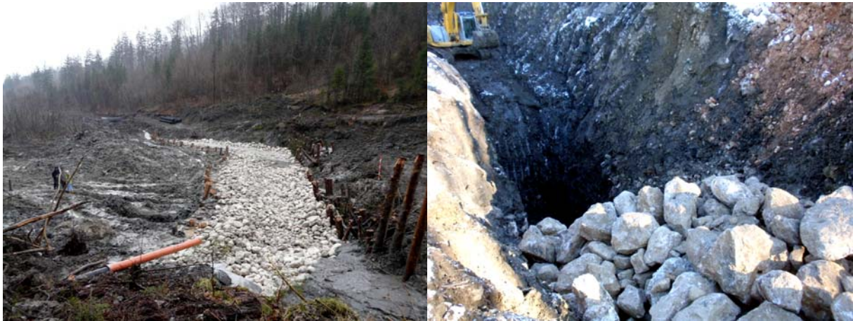
Abb. 9 und 10: Anlegen der obersten Querausleitung; durch Holzpiloten wird die Lage der Folie stabilisiert (links); bis zu 12 m tief wurden die Drainagegräben angelegt (rechts).
