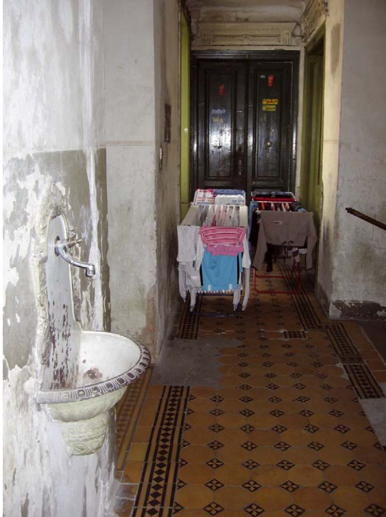
Foto 9: Haus der schlechtesten Zustandskategorie, Innenansicht mit Bassena, 1160 Wien
