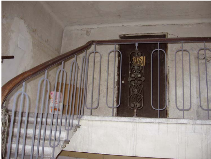
Foto 6: Beschädigungen im Flur 1981 und 2005, 1050 Wien
