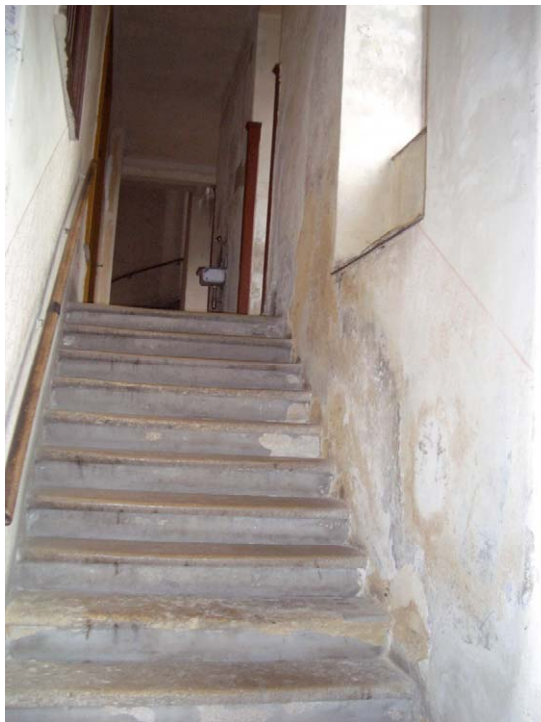
Foto 4: 1981 und 2005 alter Verputz, 1140 Wien
