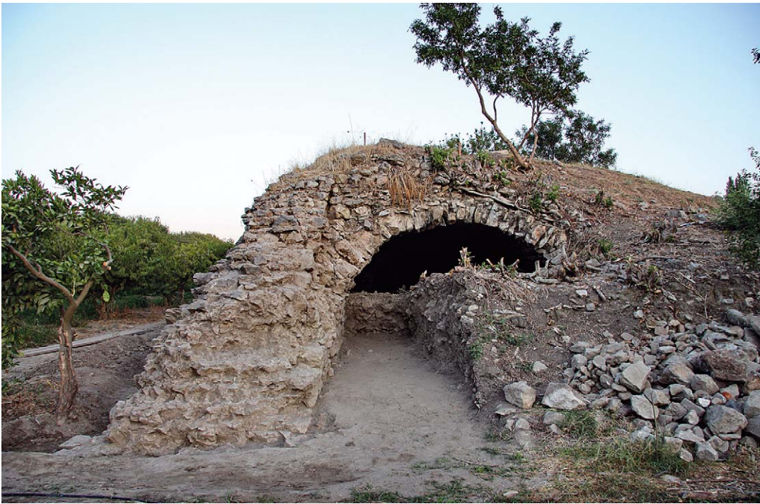
1 Kammer 1 vor partiellem Einsturz (2009), Blick nach Westen
