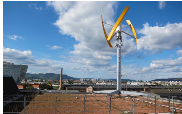
Gebäudeintegrierte Windkraftanlage in der Stadt
